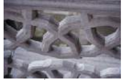
Resim-1; Zal Mahmut Paşa son cemaat yerinde mermer şebeke korkuluğunun suyunu paralel olarak iç yapısındaki kusurun ortaya çıkması sonucu meydana gelmiş çatlama,
